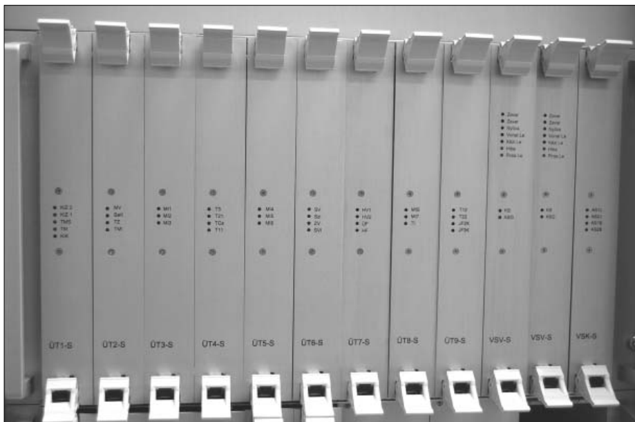
5. ábra. Teljesen kitöltött kártyafiók: 9 kártya a térközcsatlakozás illesztéséhez, 3 kártya a vonali sorompókhoz
