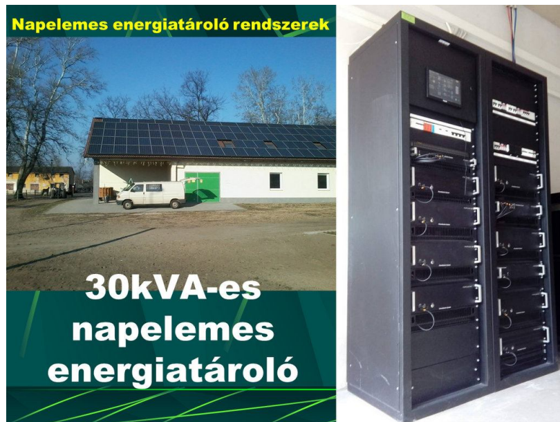
4.ábra: 30 kVA-es napelemes szünetmentes áramellátó rendszer
