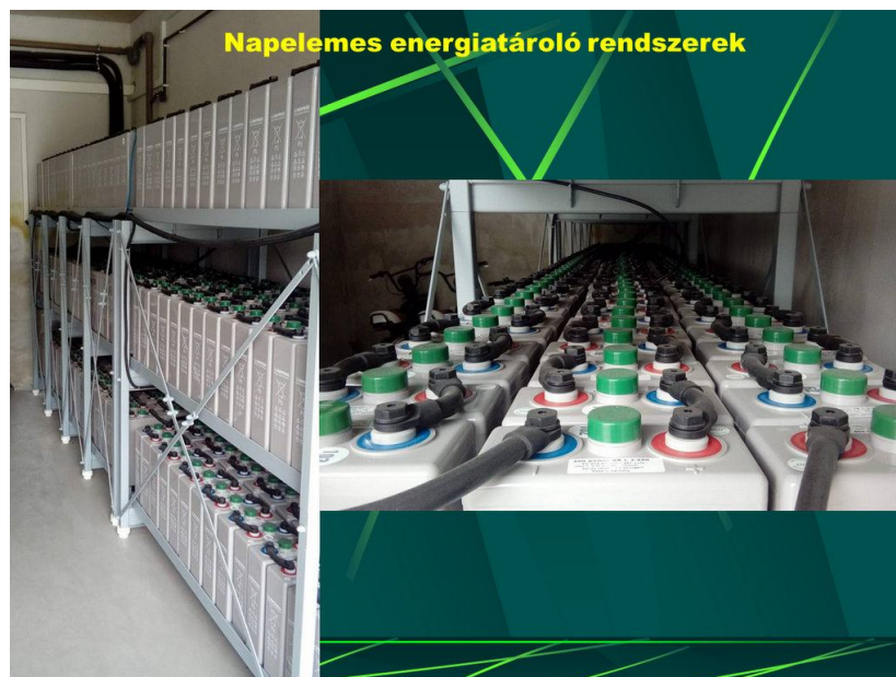
5.ábra: 30 kVA-es UPS akkumulátor telepe
